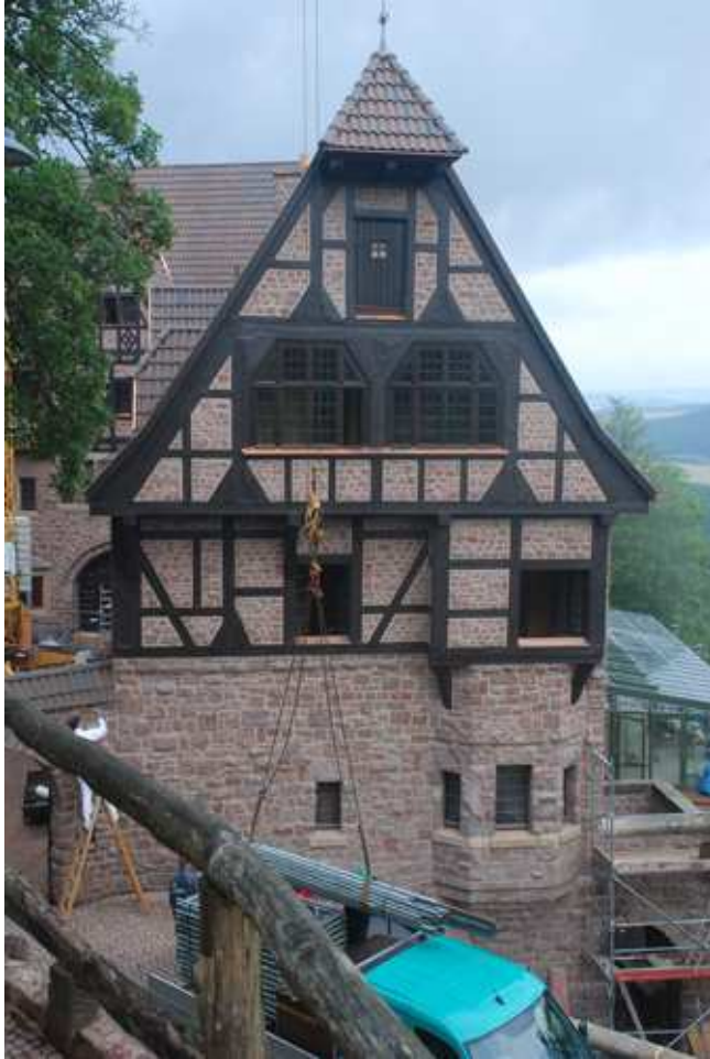
Bild 5: Wandfläche am Wartburghotel – Die Überarbeitung der Verfugung am Mauerwerk aus Wartburgkonglomerat erfolgte im Jahr 2011 mit einem von der MFPA entwickelten Mörtel.
